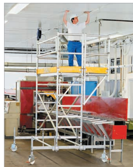
Консоли трёх размеров (длиной 1,80 м; 2,50 м и 3,00 м) крепятся к передвижным вышкам с рабочей высотой до 8,60 м.
