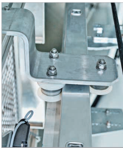
Деталь сервисного лифта
