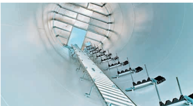
Настенная лестница для ветряной электростанции (см. с. 326)
