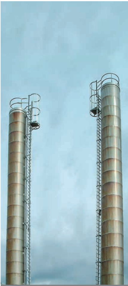
Лестницы со страховочным ограждением на трубах
