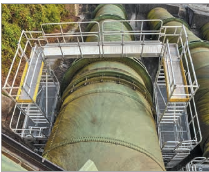
Рабочая площадка для обслуживания сливных труб ГЭС
